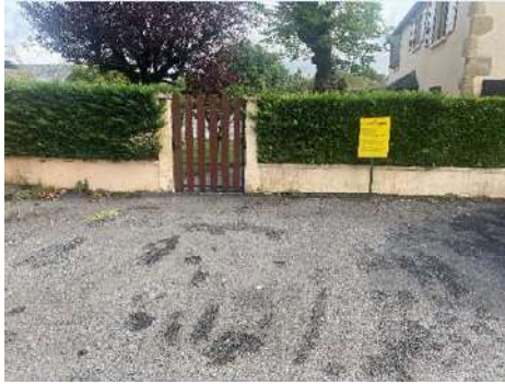
Mur de clôture construit sur le domaine public
